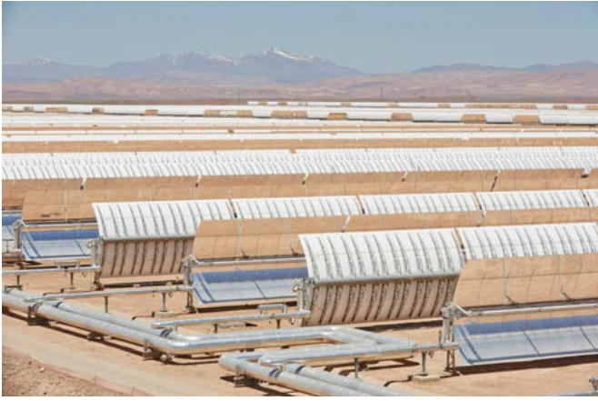
Solarkomplex NOORo I. Quelle: KfW Bildarchiv, Urheber: Jens Steingässer.
